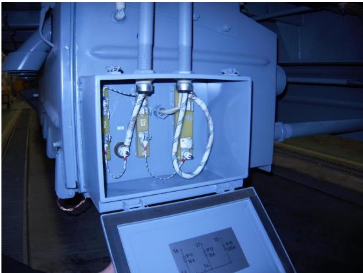
Рисунок 3 – блок предохранителей на торце аккумуляторного ящика
